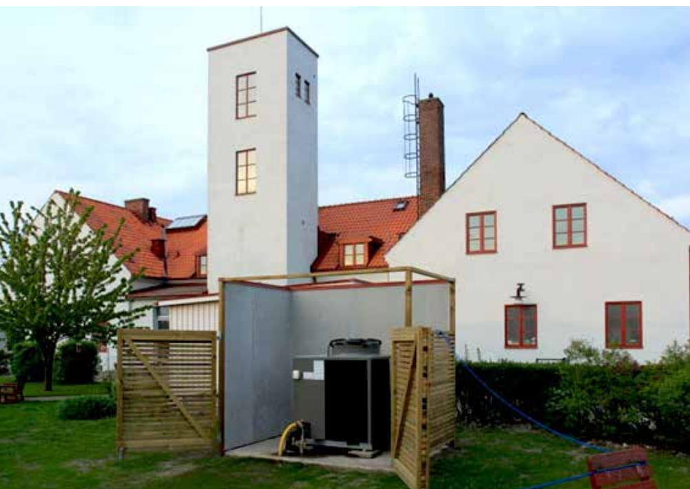
Figur 2. Sveriges första gasvärmepump (35 kW) installerades och utvärderades vid ett dagcenter i Limhamn, Malmö under 2012. Foto: Mikael Näslund
